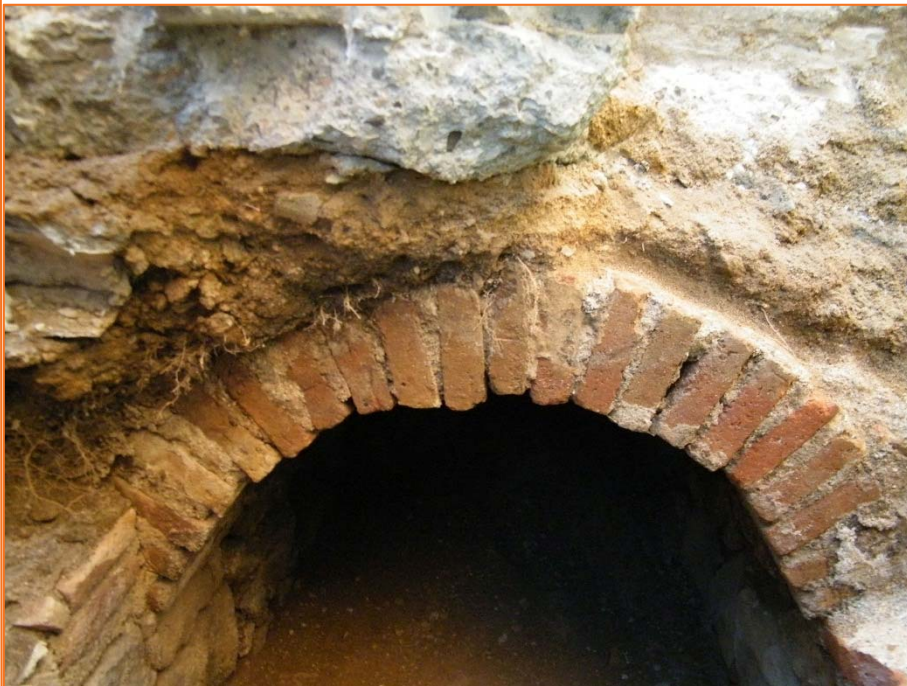
Foto 9. Volta de coberta del col·lector de carrer Carretes vista al perfil de la rasa.
